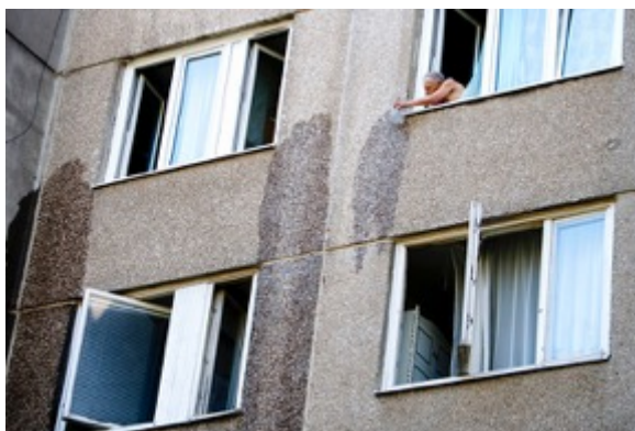
F.3.2. ábra A tulajdonos sajátos technológiával hűti a forró panel falfelületét
