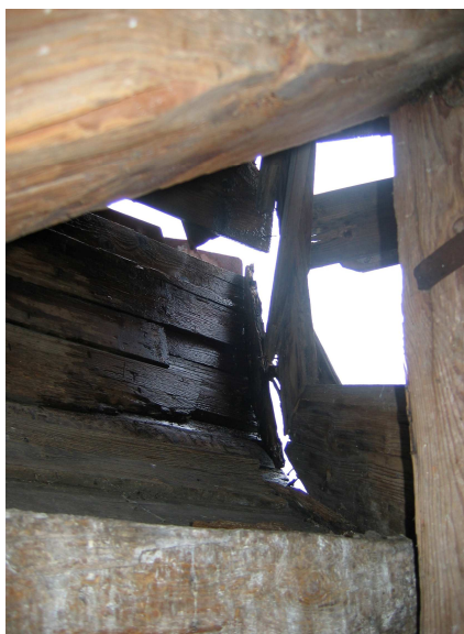
a deszkázat a beázások helyein teljesen elkorhadt 372
