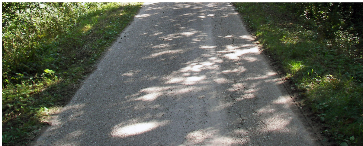
7.6. ábra. Az aszfaltréteg kimerülésére utalnak a jól kivehető hosszirány repedések.
