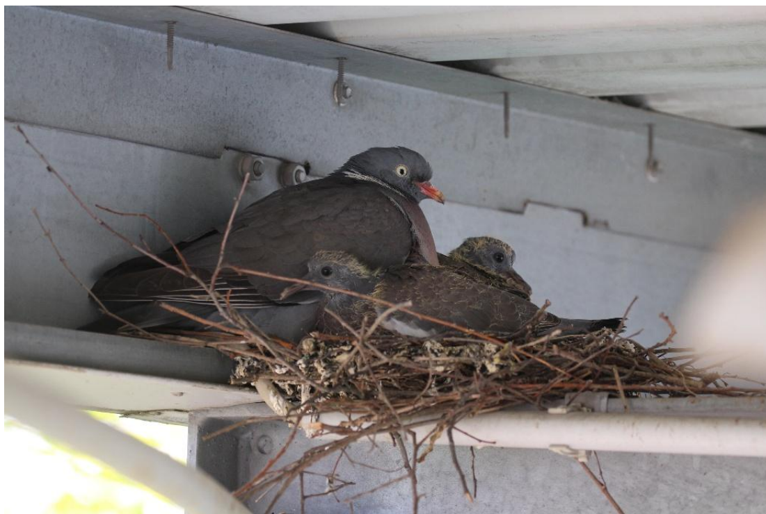
5. ábra: Gyárépület acélszerkezetén sikeresen költő örvös galamb és fiókái, Sopron 2023.05.23. (Saját felvétel)
